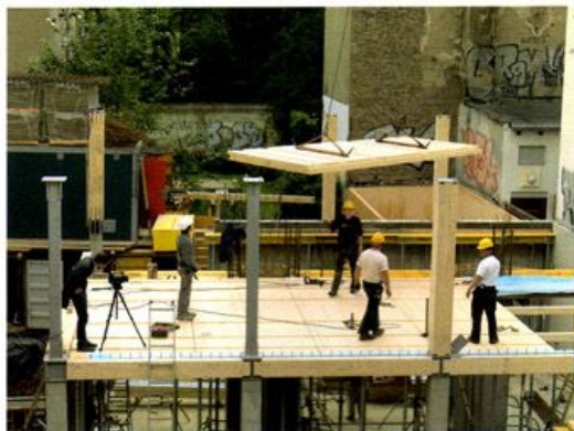
Verlegung der Brettstapelelemente über dem Erdgeschoss: Die Kombination von Holz, Beton und Stahl war mit den Standard-Knoten in gleicher Weise möglich; gut zu erkennen die Ausblattungen für den Schubverbund Holz - Beton.
