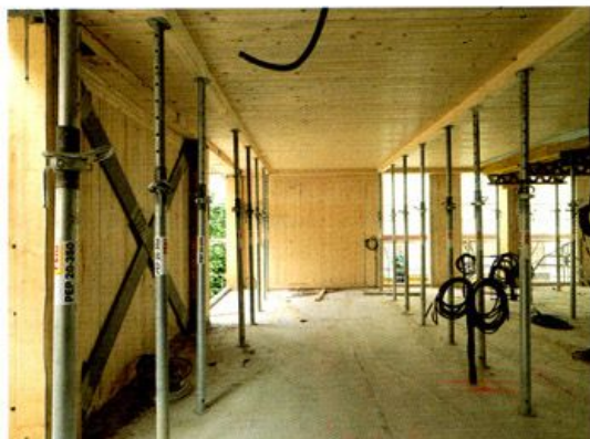
Blick in den Rohbau, links die mächtige Stahlauskreuzung, je Geschoss und Außenwand wurde nur ein Feld ausgekreuzt. Die Baubehelfe zur Unterstützung der Decken mussten wegen der Abbindezeiten des Betons bis zur Rohbau-Fertigstellung stehen bleiben.
